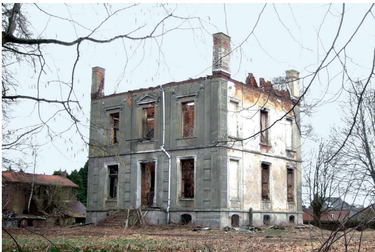
Figure 11. Le « château Le Docte » en triste état depuis l'incendie de 1999. Chastre, rue de la Sucrierie, 26. Photo Paul GOUVERNEUR, février 2011.
